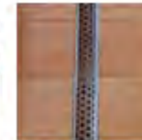
冷風排出し口
