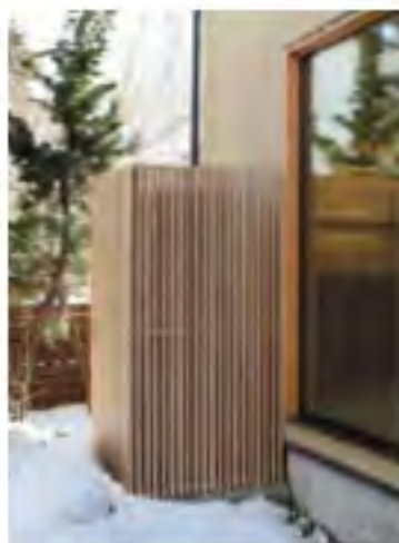
雨水利用システム(タンク)
