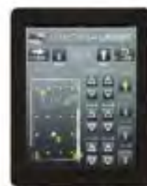
照明コントロール画面
